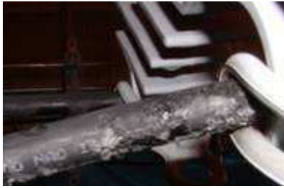
Figura 3: Trilhamento elétrico e erosão no cabo protegido.
